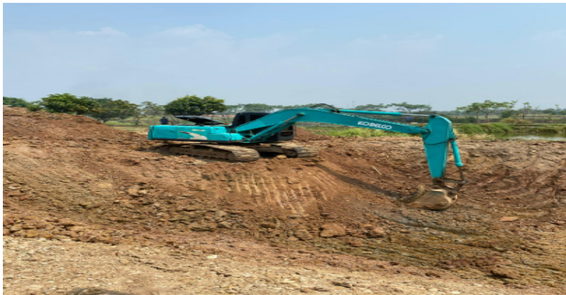
Gambar 51 Proses penggalian tanah leo, yaitu lokasi bekas galian batu bata yang akan digunakan untuk pembuatan Empang Ikan Patin di Desa Cipayung, Cikarang Timur, Kab. Bekasi. Gambar diambil 3 September 2024.
